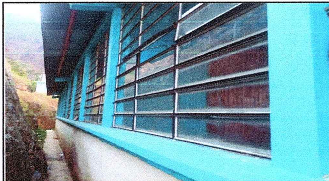
Foto 3: vista de establecimiento donde se observa la necesidad de colocar canales y bajadas de agua pluvial de forma formal
