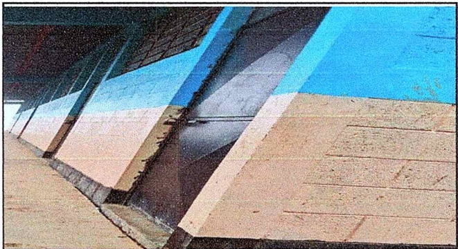
Foto 4: puertas del establecimiento en mal estados, que es necesaria el mantenimiento
