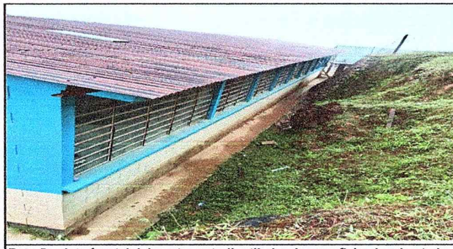
Foto 5: vista frontal del centro estudiantil, donde se refleja el mal estado en que se encuentra el entechado.
