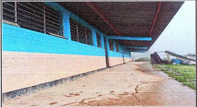
Foto 2: paredes del centro educativo donde se puede verificar la necesidad de ampliación de pinturas en paredes, ya que hace tiempo no se ha dado mantenimiento por falta de recurso económico
