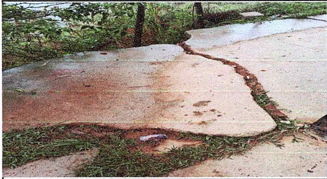
Foto 1: patio del establecimiento donde se puede evidenciar la necesidad de sustitución de plancha de concreto
